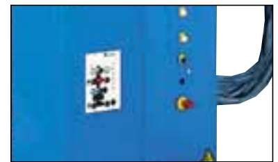
CE ausgezeichneter Schaltschrank
